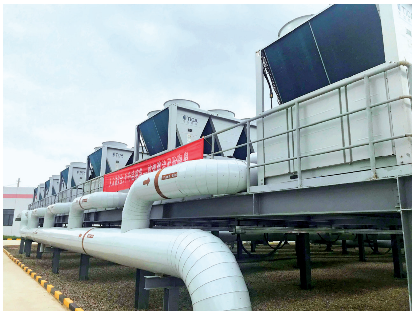
兴海县绿电供暖设备。 拍摄 / 张宁国
