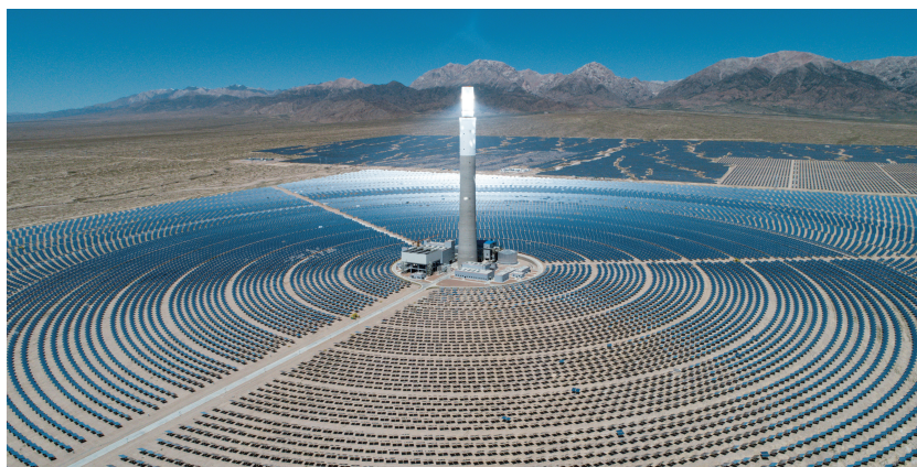
海南州塔拉滩光伏园区。 摄影 / 黎晓刚
