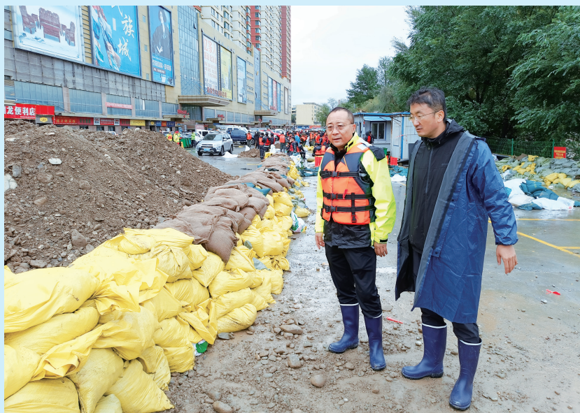
西宁市湟水河城东区泰阳国际段堤防出现险情后，蒋志刚（左）在现场调度防汛物资储备。 供图 / 代表本人
